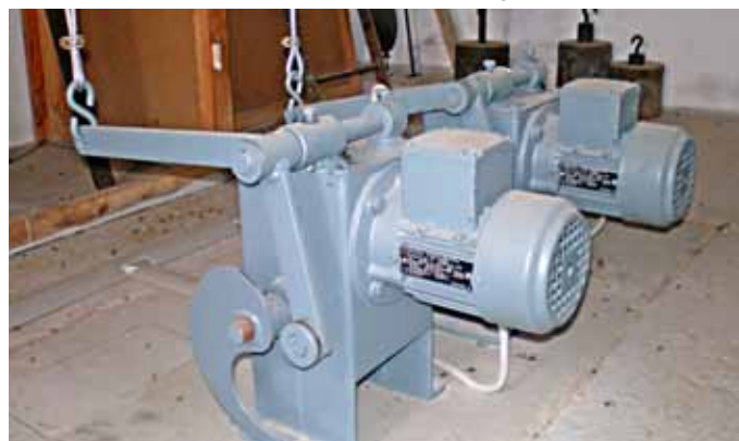
Die Motoren für den Viertel- und Stundenschlag
